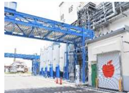
【リンゴ酸設備】
